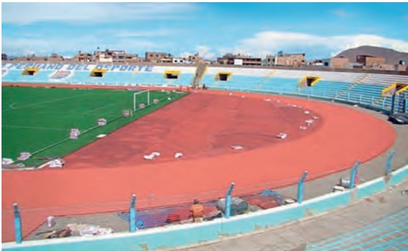
■ Obra: Mejoramiento de la Pista Atlética del Estadio Enrique Torres Belón - Puno.
