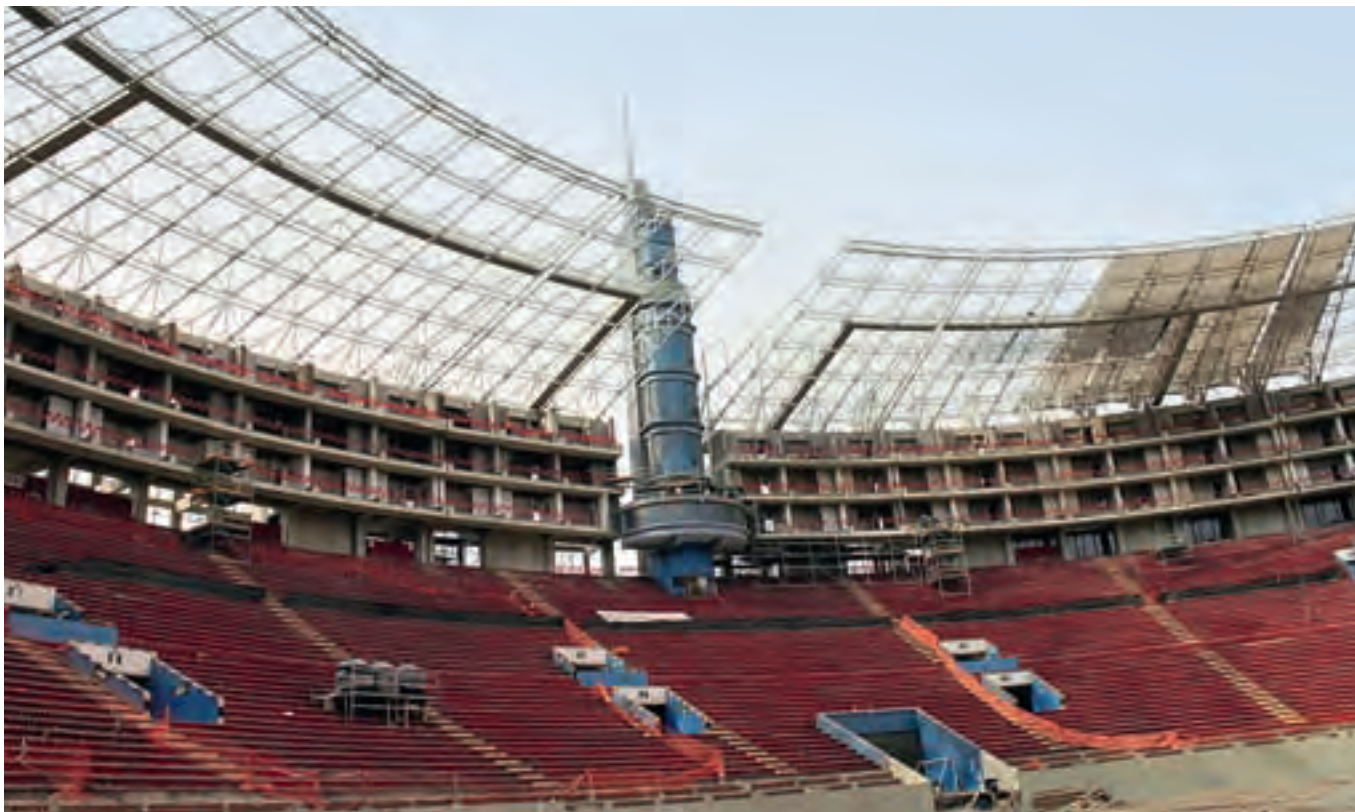
■ Obra: Rehabilitación, remodelación y equipamiento de la infraestructura deportiva del Estadio Nacional – colocación de techo metálico.
